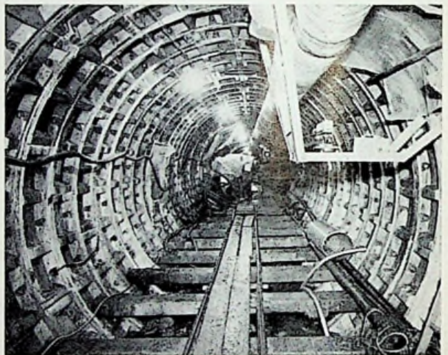
Afb. 4 - Tunnelbouw met behulp van een laser interferometer. De besturingsinstallatie bevindt zich rechts van het midden op de stelling.
